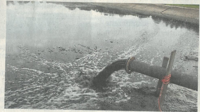
Der Zulauf in das erste Becken: Neben Wasser und Schlamm wird auch etwas Sand und Kies mitangesaugt.
